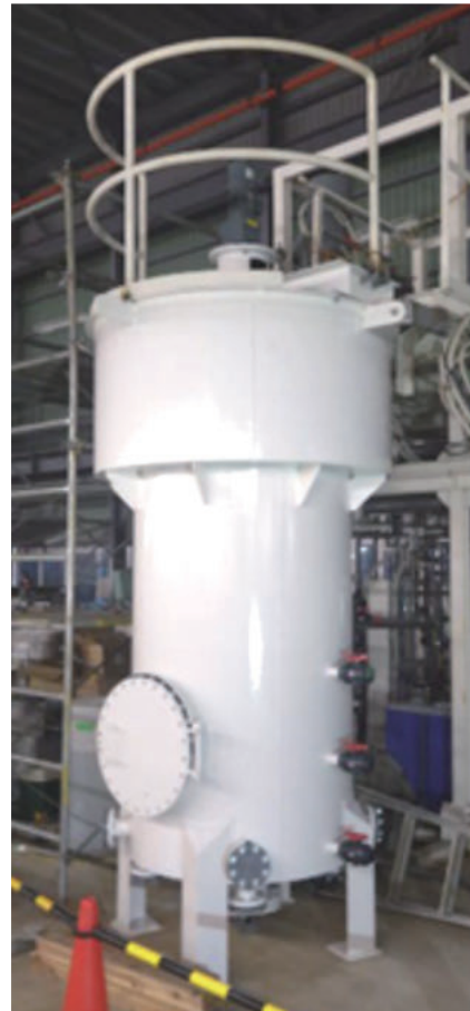
図2 パイロットプラント造粒沈殿槽（沈殿面積1.0m 2 ）
