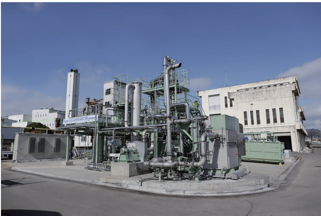
写真1 鹿沼市黒川終末処理場に導入された設備
